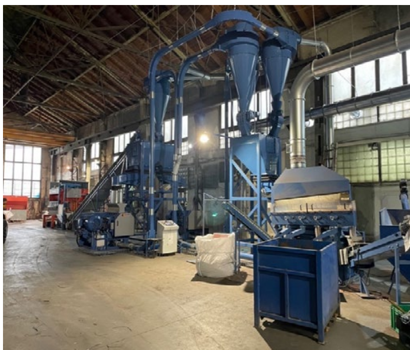
Linia technologiczna w Mercury HM, przy wykorzystaniu której realizowana jest technologia recyklingu miedzi z kabli
